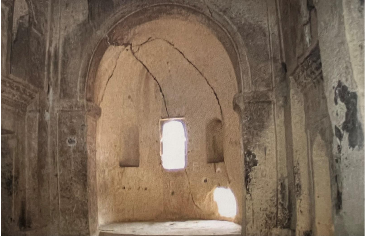
Εικόνα 20 - Οι ρωγμές στο εσωτερικό του παλαιού Ναού Αγίου Γεωργίου
